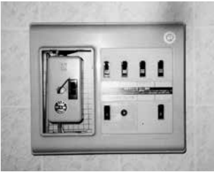
電気のブレーカー Power circuit breaker
